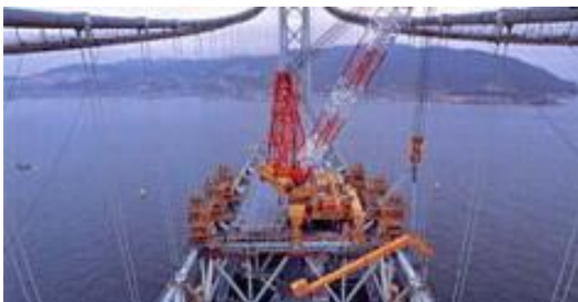
トラバークレーン
