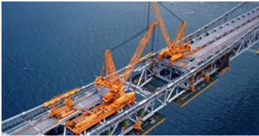
トラバークレーン
