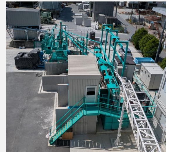
加西実証プラント排水処理設備
